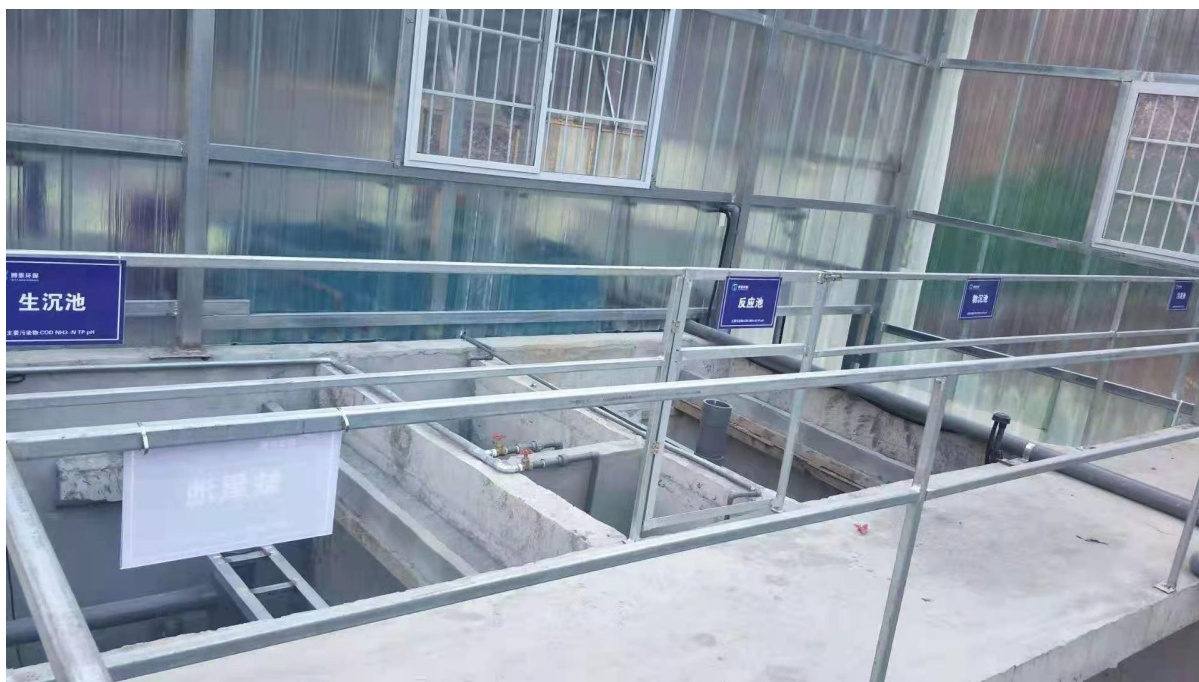
粪污处理设施
