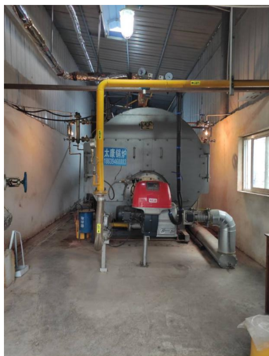
依托工程（燃气蒸汽锅炉）
