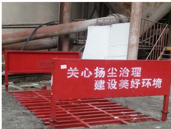
车辆冲洗装置
