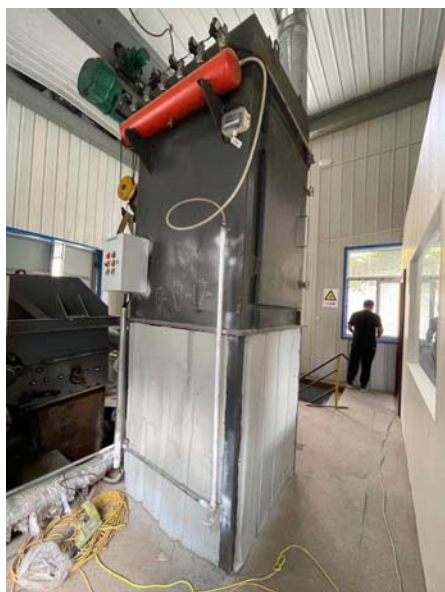
袋式除尘器下灰口全密闭
