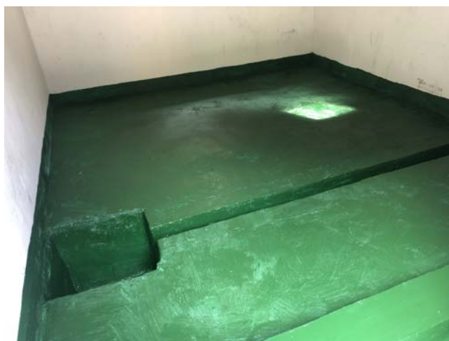
硝酸库地面防渗及应急导流收集池
