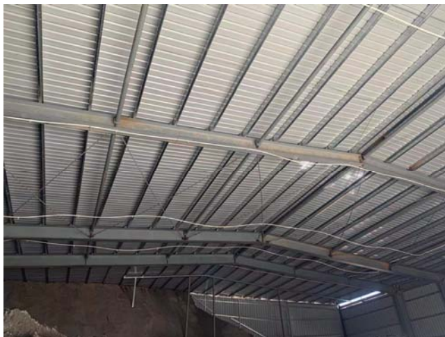
过滤车间喷干雾装置
