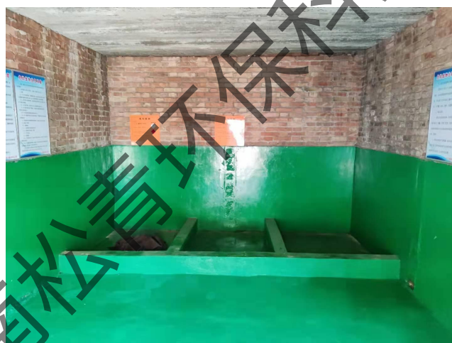
危废暂存间防渗
