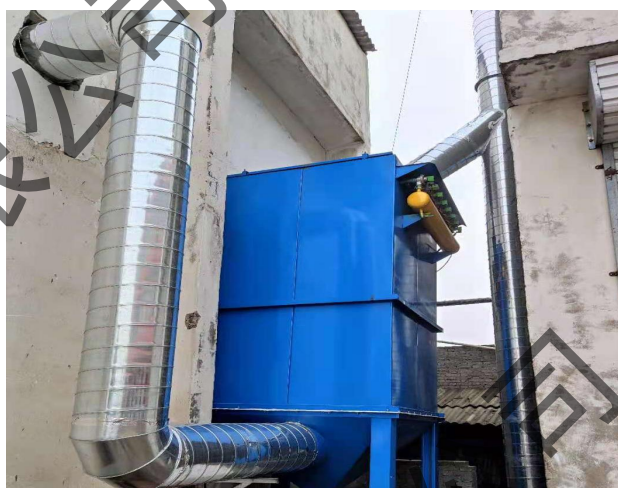
搅拌区袋式除尘器
