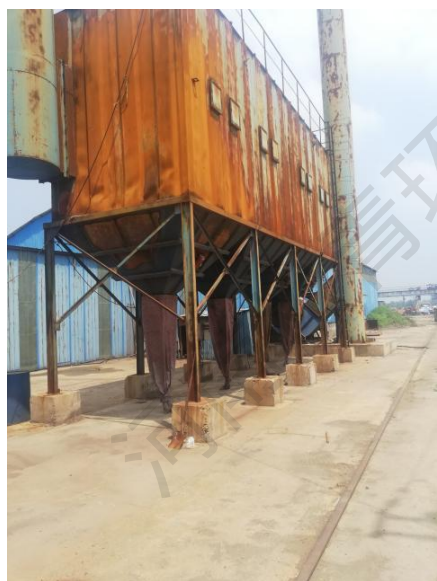
除尘器+排气筒
