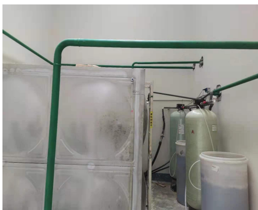
软水制备装置
