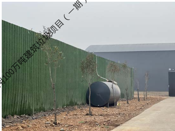
厂区道路两侧喷淋装置
