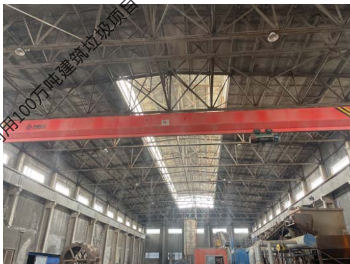
车间顶部设置喷干雾抑尘装置
