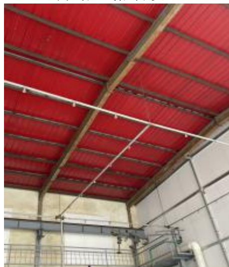
液氯罩棚碱喷淋装置
