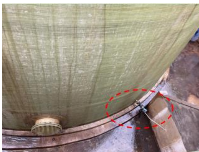
盐酸储罐泄露报警器
