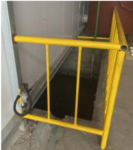
液氯泄露事故碱池 1#
