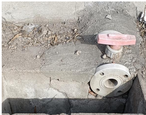
盐酸储罐雨水闸阀
