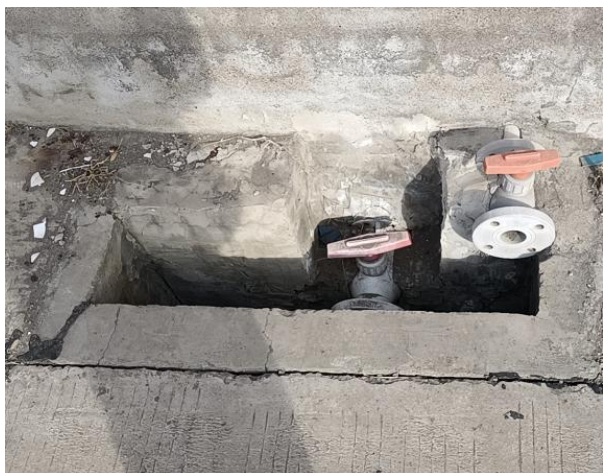
石蜡储罐区雨水闸阀
