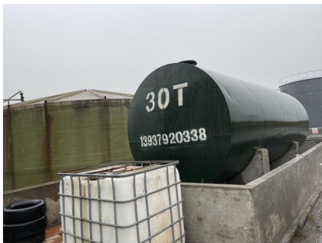
次氯酸钠储罐围堰
