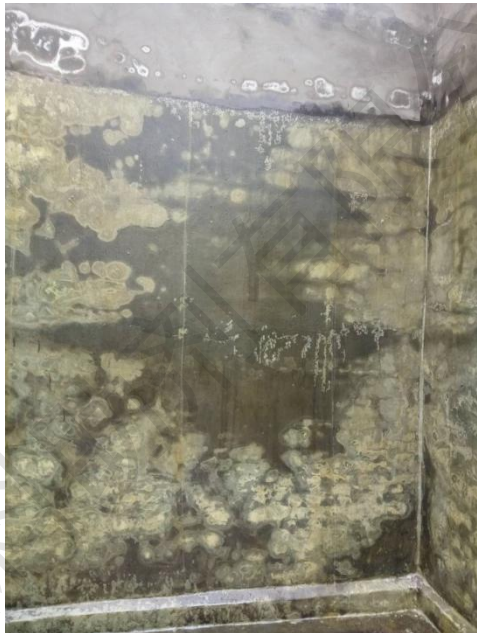
盐酸罐区（侧壁增加防渗防腐措施）
