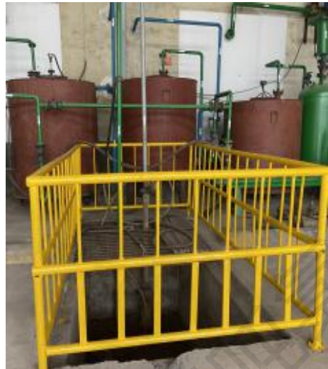
液氯泄露事故碱池 2#
