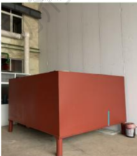
废气泄露事故碱池
