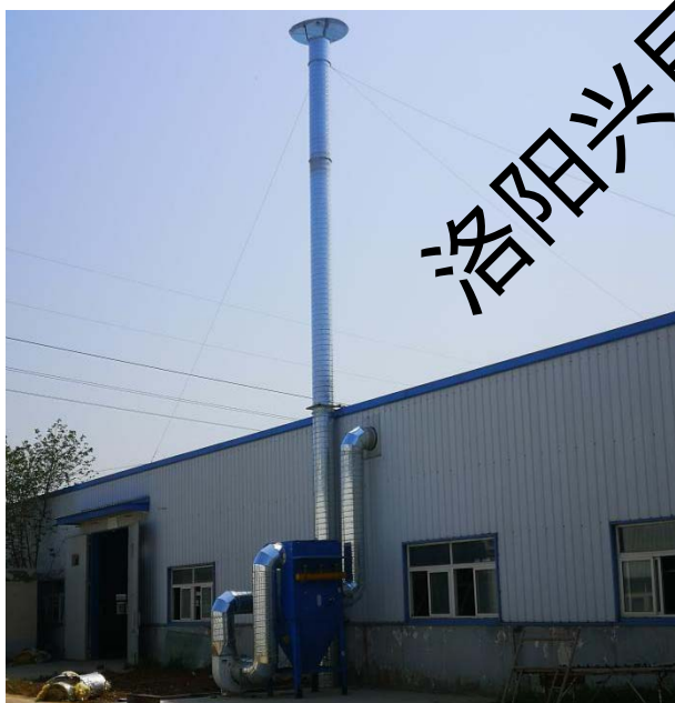
焊接、激光切割除尘器
