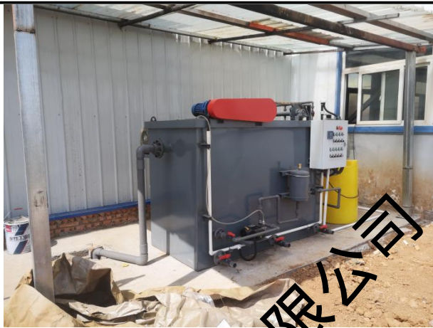
废水处理设施
