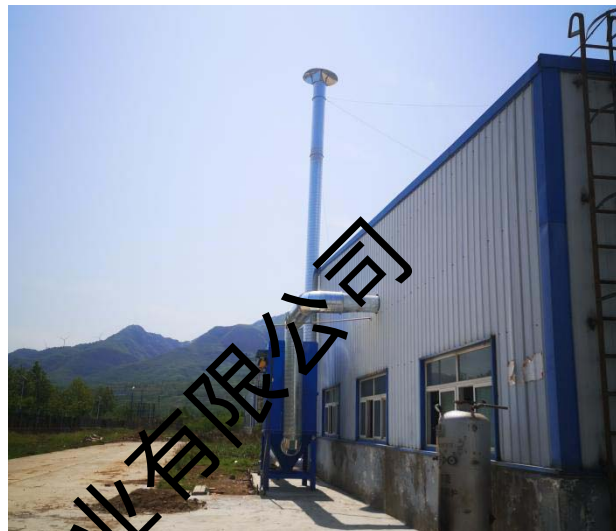
木制门车间袋式除尘器
