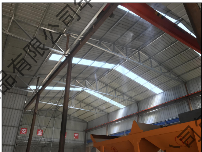
车间喷干雾装置
