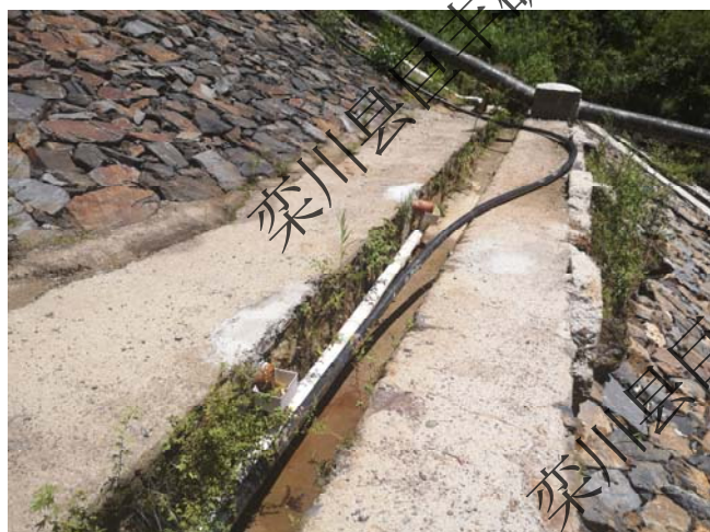
排水沟及渗滤液收集管道
