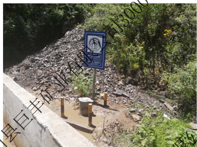
尾矿库坝下地下水监测井
