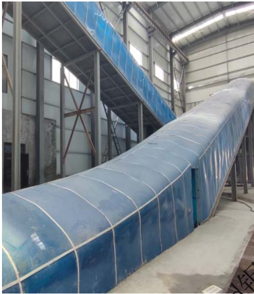
破碎筛分车间密闭皮带廊
