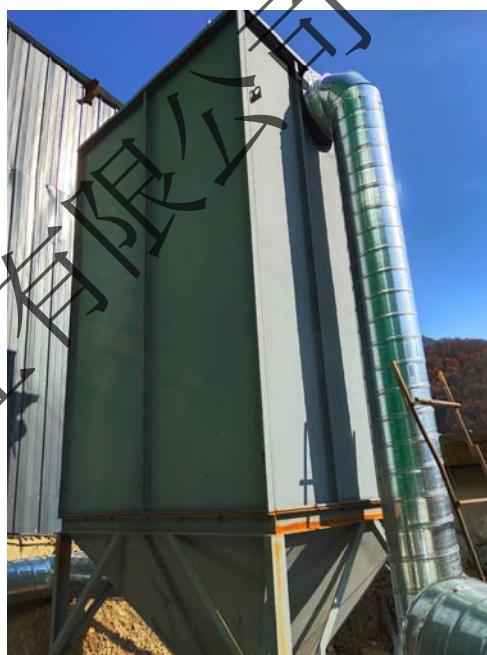
鄂破上料口配套高效覆膜袋式除尘器 (TA001)
