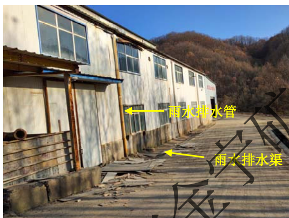
选矿车间雨水排水管及地面雨水排水渠
