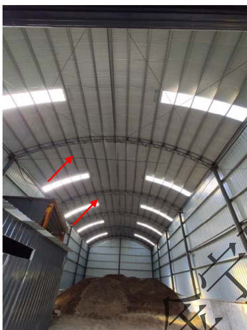
原料库顶部设置雾降尘装置
