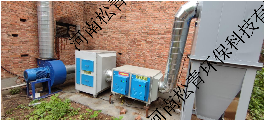
项目除尘器+低温等离子+活性炭吸附装置+排气筒 DA001
