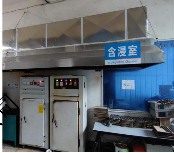
项目含浸加热间集气装置
