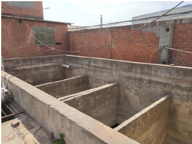
循环冷却水水池
