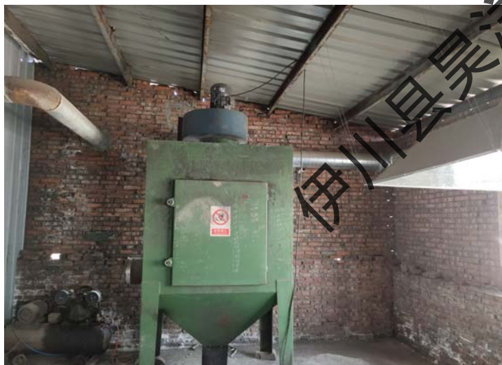
焊接、打磨区配套除尘器（TA003）
