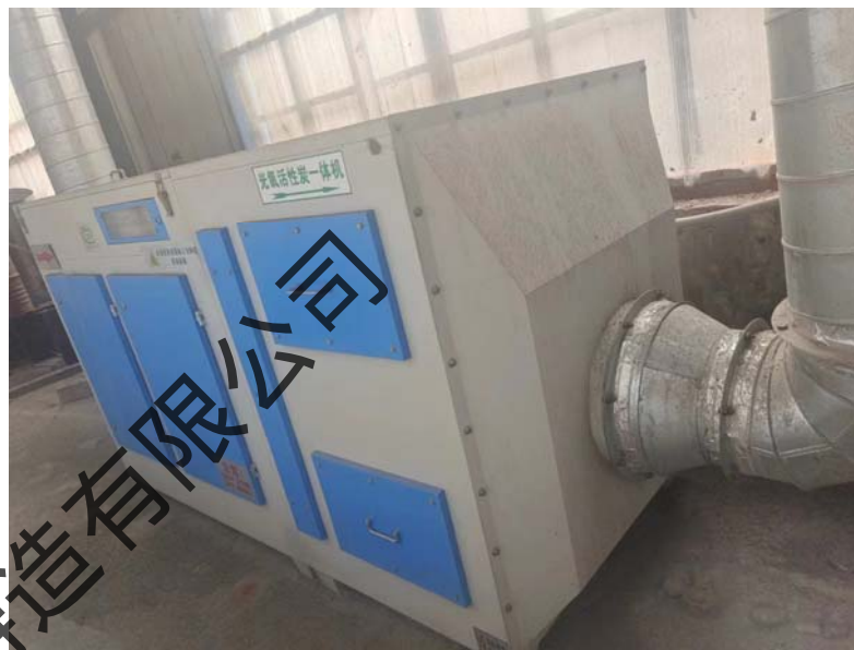
消失模浇铸 VOC 废气 UV+活性炭处理设施（TA001）
