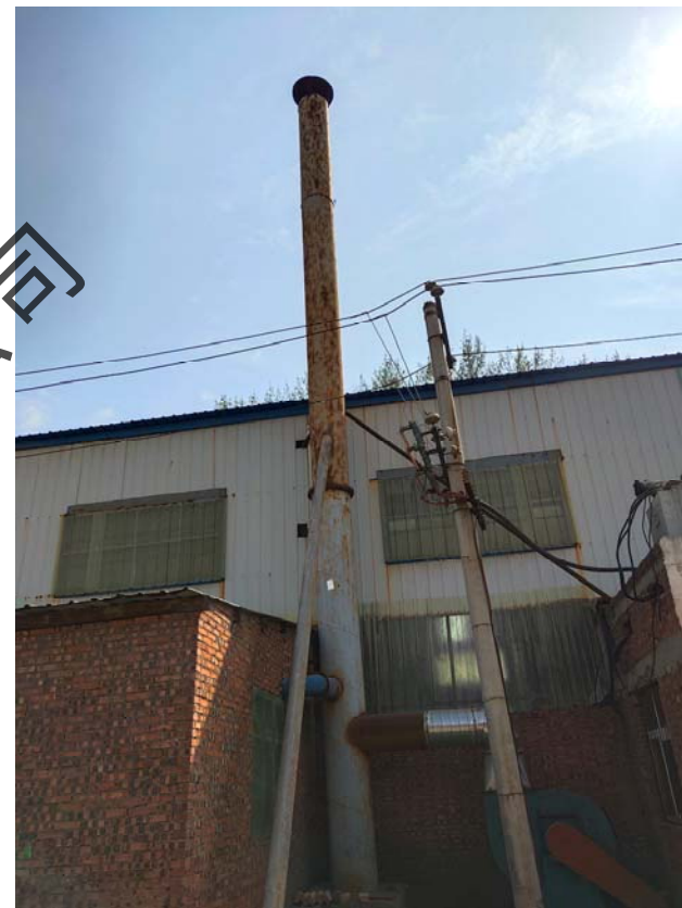
厂区废气总排口（DA001）排气筒
