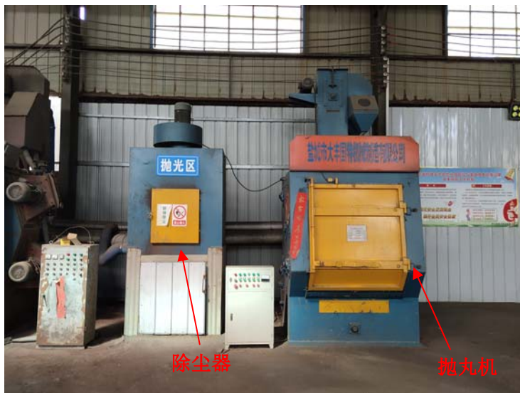
抛丸机密闭措施及除尘器（TA002）
