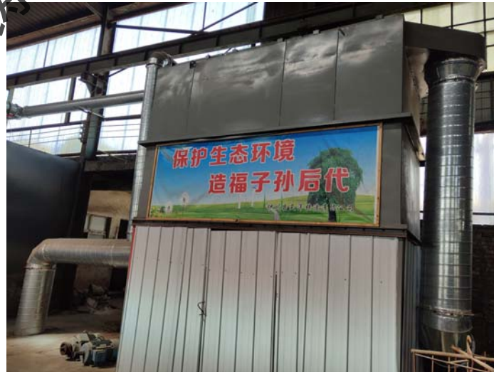
熔炼、浇铸、水玻璃石英砂混砂造型、落砂消失模生产线造型、落砂、砂处理废气配套除尘器(TA001)
