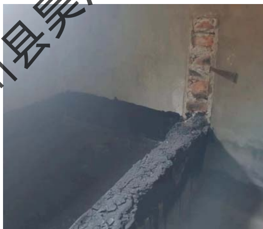
危废暂存间（内部）围堰、防渗措施
