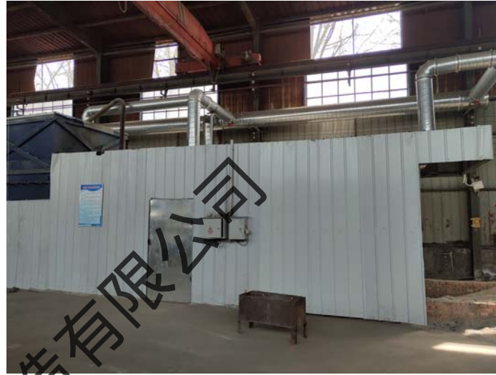
消失模落砂区集气罩、砂处理设备全封闭措施
