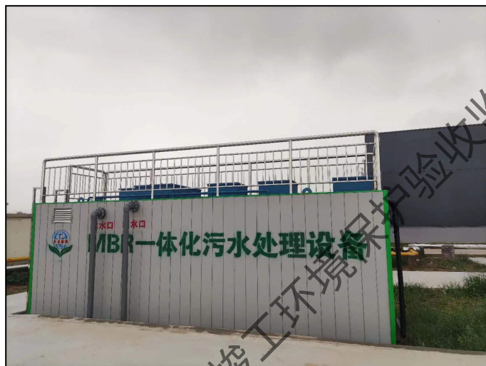
生活污水处理设施
