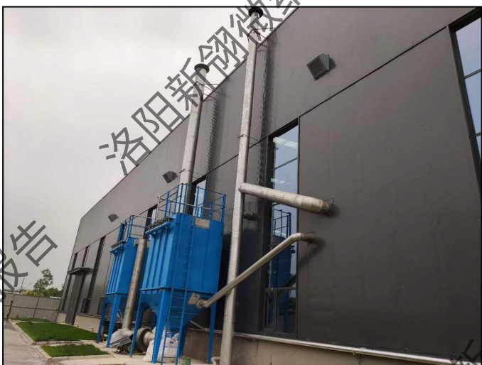
袋式除尘器废气治理设施
