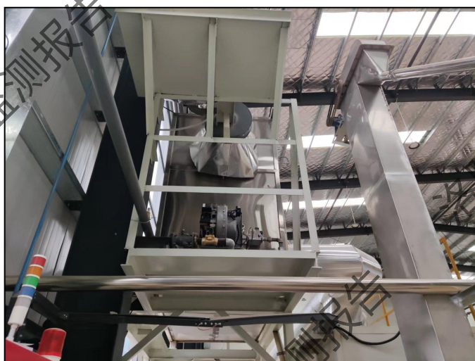
天然气低氮燃烧装置
