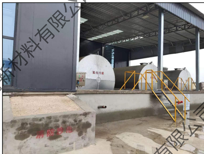
液体原料储罐区
