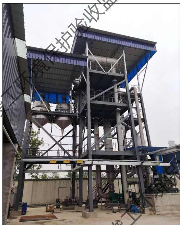
MVR 三效蒸发装置
