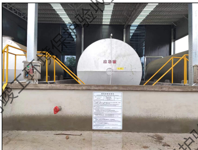
事故应急储罐
