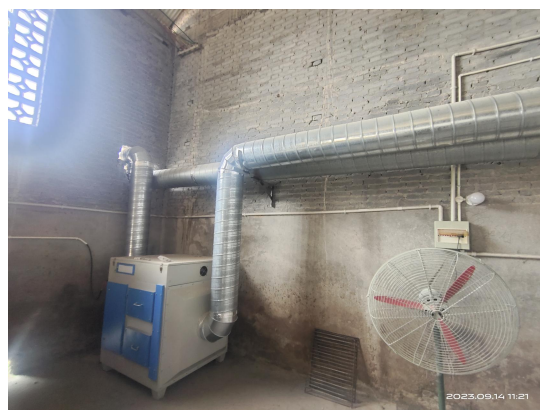
浸渗工序废气治理设施
