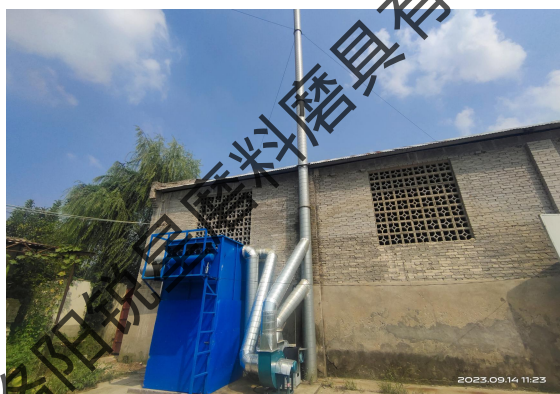
切割工序除尘器
