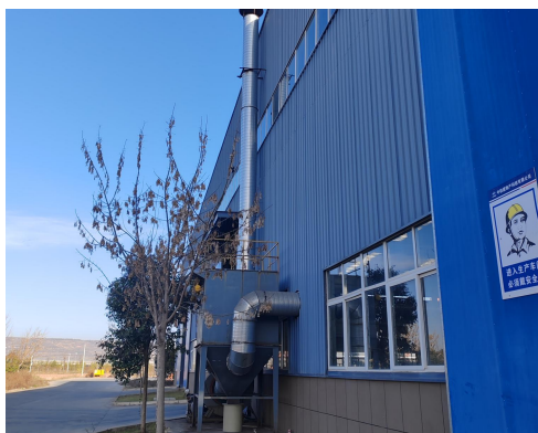
拼装焊接废气处理装置
