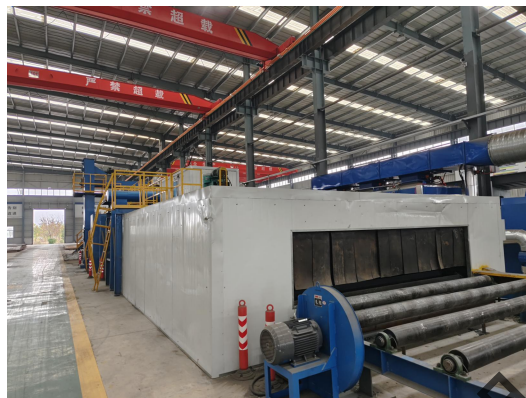
喷涂工序密闭及收集装置
