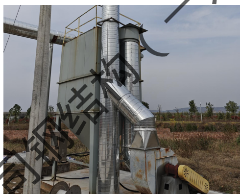
焊接废气处理装置
