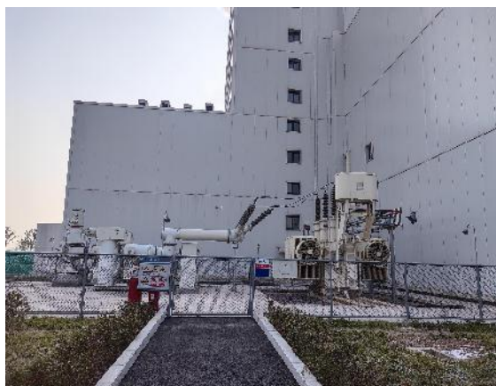
图 6-2 消防设施+警示牌
