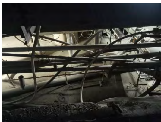
车间内事故池
