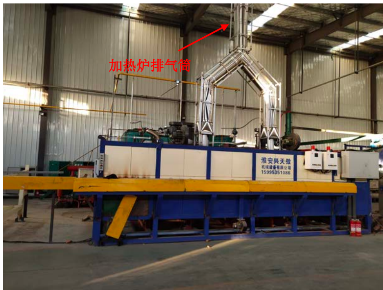
铝棒加热炉封闭措施及 DA003 排气筒
