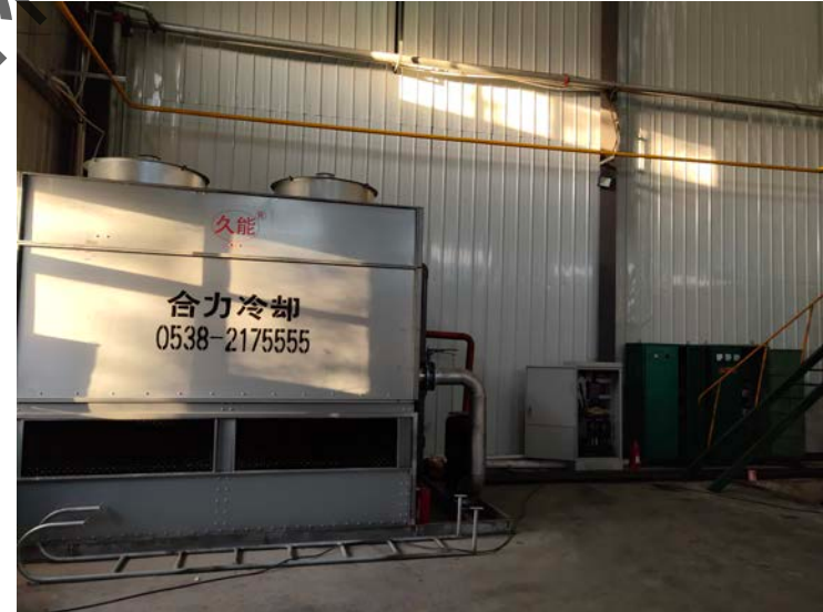
设备循环冷却水水池
