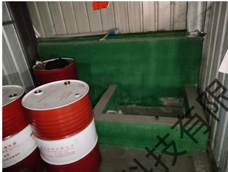
危废间内部围堰、防渗措施
