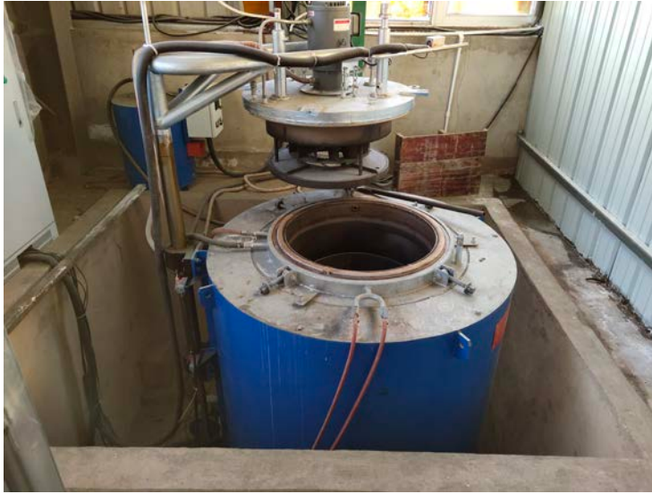
渗氮炉密闭措施
