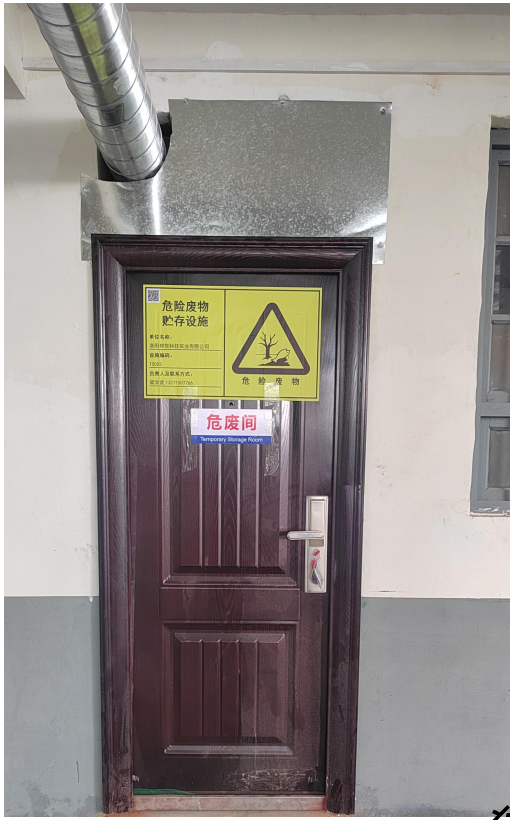
危废间及集气管道
