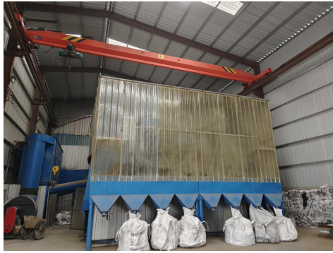
生产线二次封闭措施
