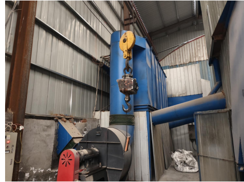
生产线除尘装置
