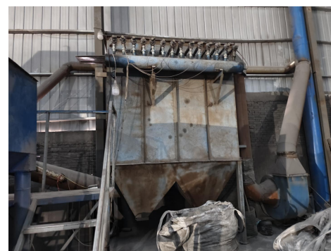
2#风洗机除尘器
