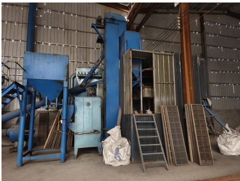
1#风洗机封闭措施
