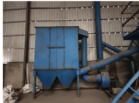
1#风洗机除尘器
