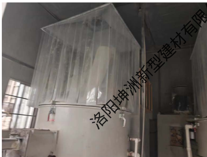
搅拌机搅拌粉尘设置集气罩及设置封闭间
