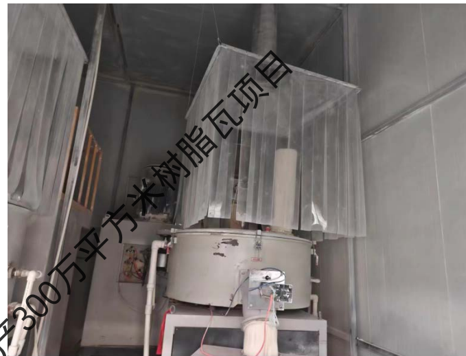
搅拌机搅拌粉尘设置集气罩及设置封闭间
