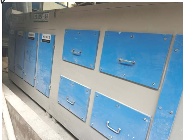
TA002 UV 光氧催化+活性炭吸附废气处理设施
