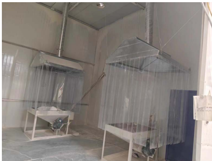
上料机投料粉尘集气罩及封闭间
