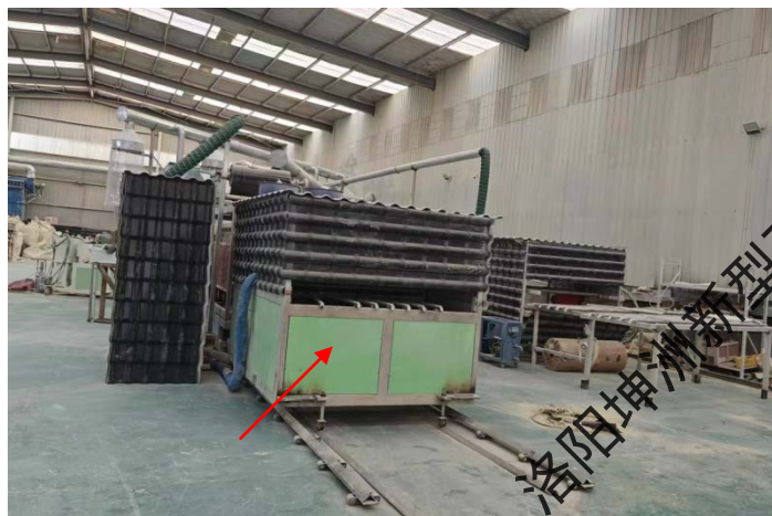
切割机局部封闭，上部设置集气罩
