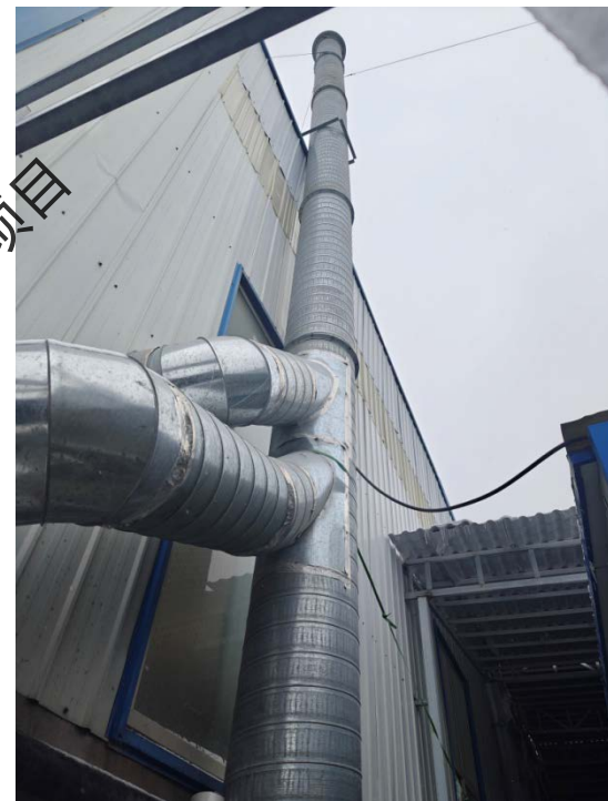
全厂废气总排口（P1 排气筒）
