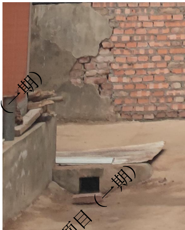
项目初期雨水收集池
