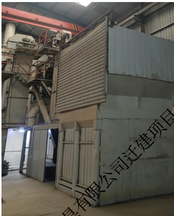
项目常规生产线进料口
