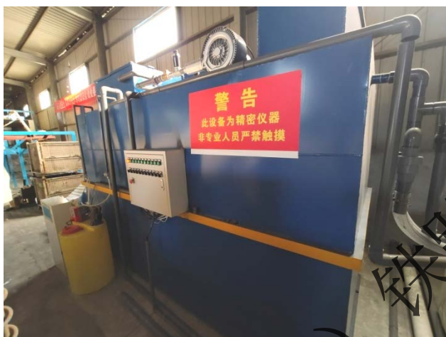
污水处理站一体化处理措施（水解酸化+接触氧化+沉淀+石英砂、活性炭过滤+纳滤）
