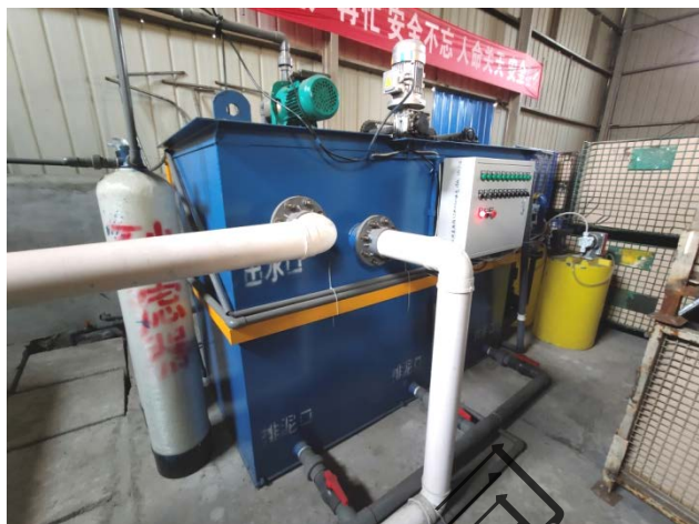
污水处理站混凝气浮设施
