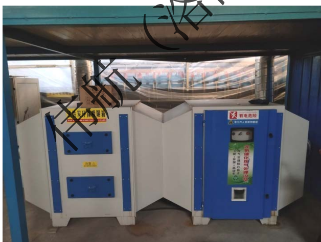
电泳涂装、烘干废气配套的 UV+活性炭废气处理设施（TA001）
