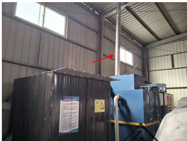
污水处理站和危废间废气排气筒（DA002）
