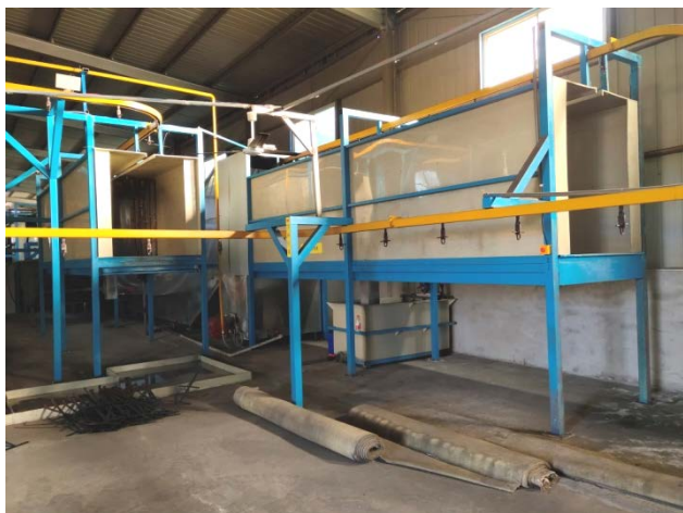
喷淋棚体下部设置循环水池
