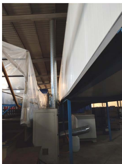
电泳涂装、烘干废气排气筒（DA001）
