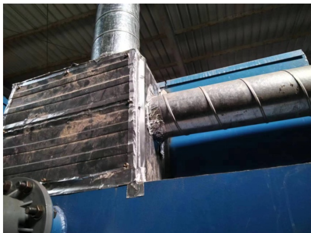
污水处理站和危废间废气处理设施（TA002）
