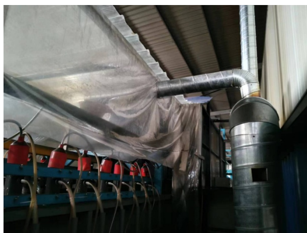
电泳槽设置集气罩将废气收集进 TA001 废气处理设施处理
