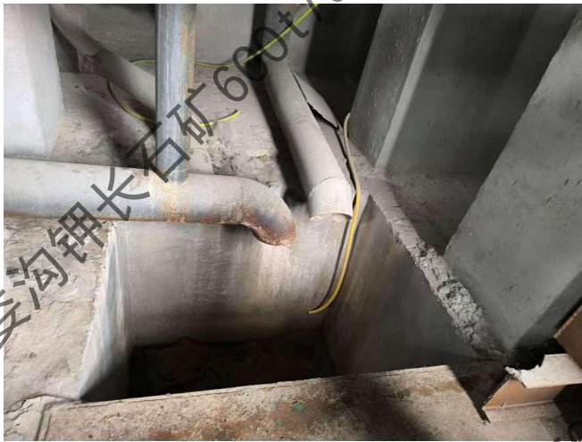
浮选车间事故池
