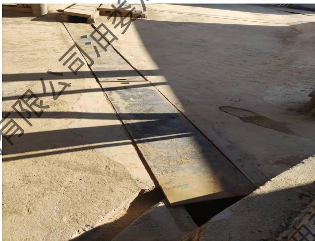
厂区雨水管线
