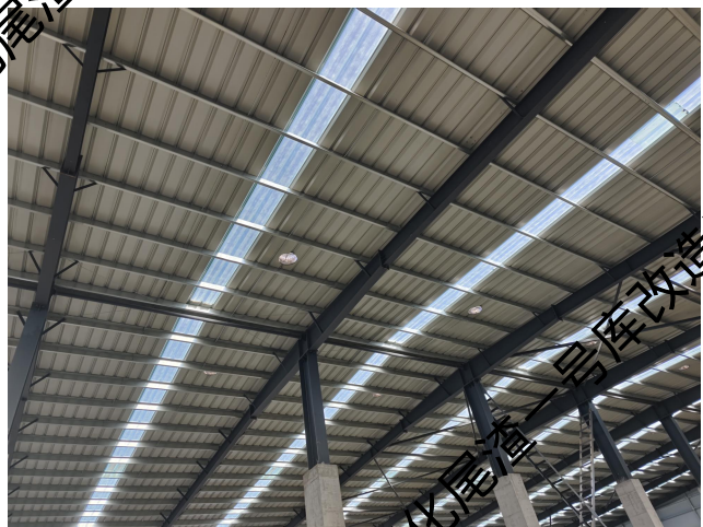
车间通风装置
