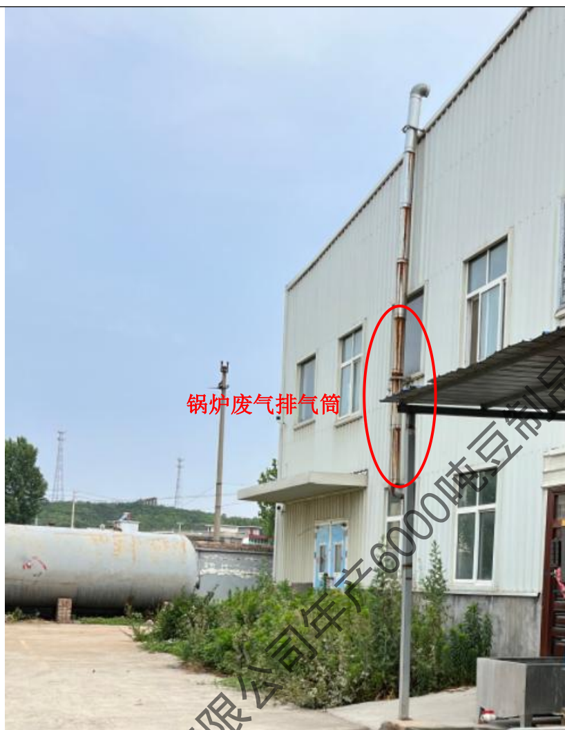
锅炉配套排气筒
