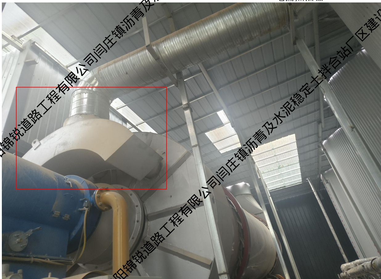
经过“电捕焦油器”处理的废气通入经烘干筒燃烧器进行燃烧处理
