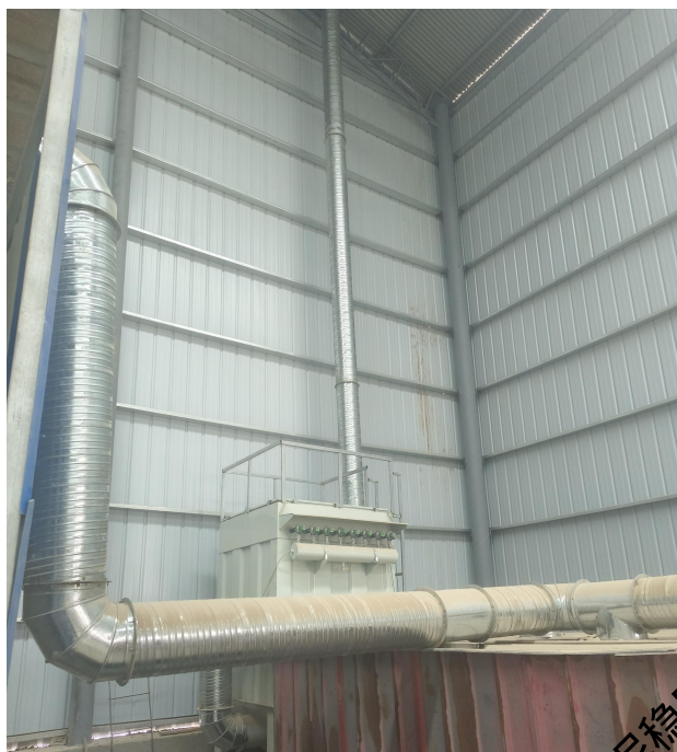
沥青拌合料下料粉尘覆膜袋式除尘器
