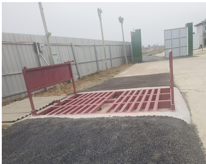
车辆冲洗装置及沉淀池
