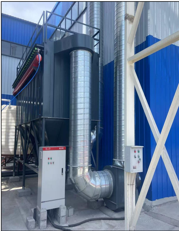
喂料工序除尘器
