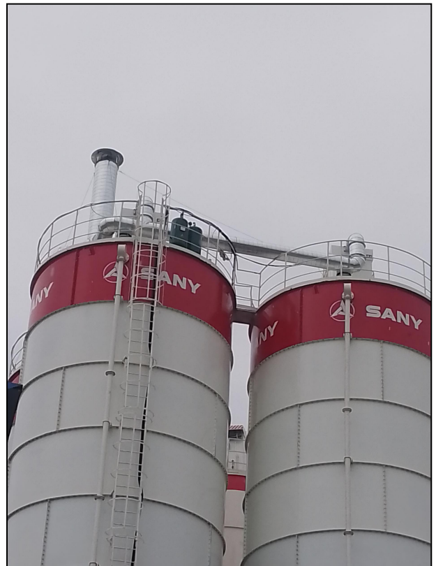
储罐除尘器及排气筒
