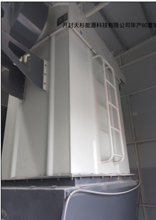
搅拌工序除尘器
