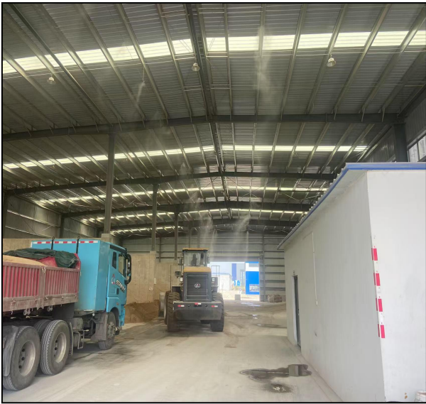
原料库内喷干雾装置
