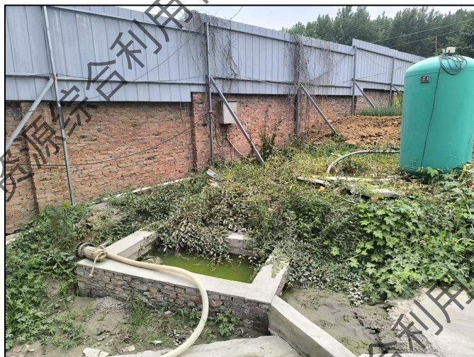
车辆冲洗沉淀池
