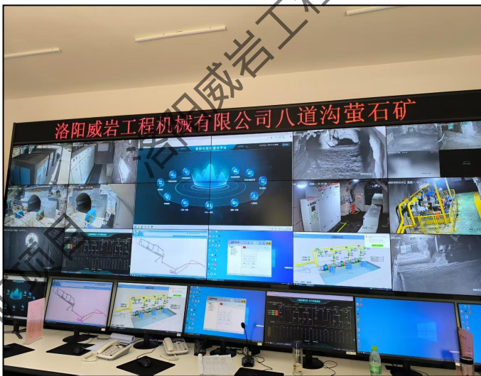
矿山监控中心
